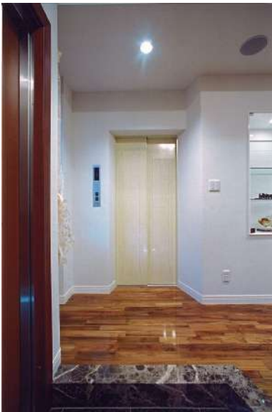
【その他設備】新築時の写真です。室内エレベーターです。
