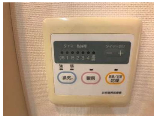
[専用部・室内写真][発電・温水設備]浴室 リモコン
