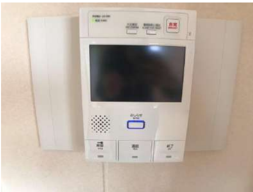
[専用部・室内写真][TVモニタ付きインターホン] テレビモニター付きインターホン
