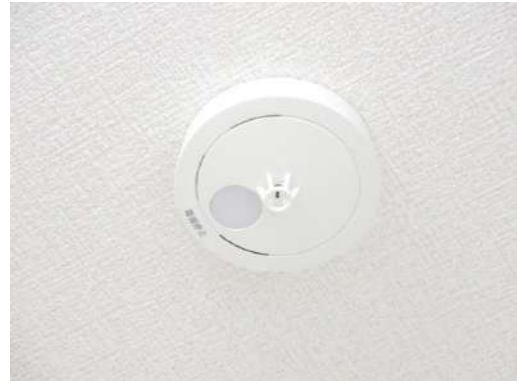
全居室に火災警報器を設置。
