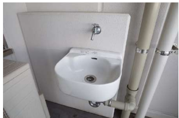
[専用部・室内写真][その他設備]バルコニーにはスロップシンクも。
