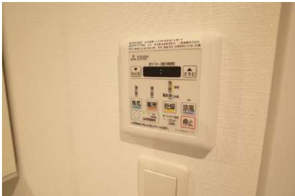
[専用部・室内写真][その他設備]浴室には暖房換気乾燥機付き。
