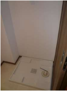
[専用部・室内写真][その他設備]
