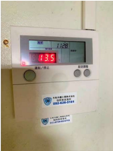
【冷暖房・空調設備】
