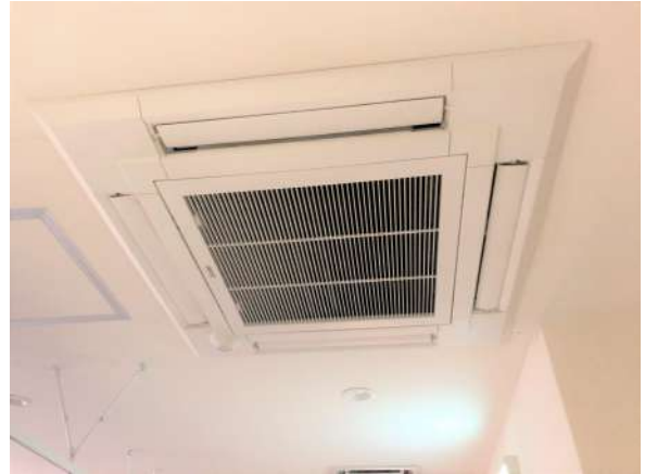
【冷暖房・空調設備】ビルトイン空調設備
