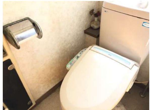
洗浄便座付きのトイレです。
