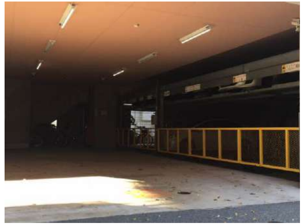
機械式駐車場
