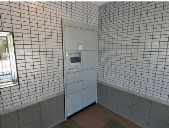
【宅配ボックス】
