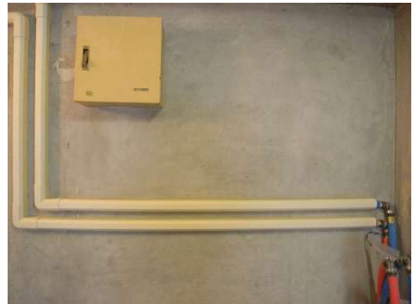
キッチン周辺の水道配管
