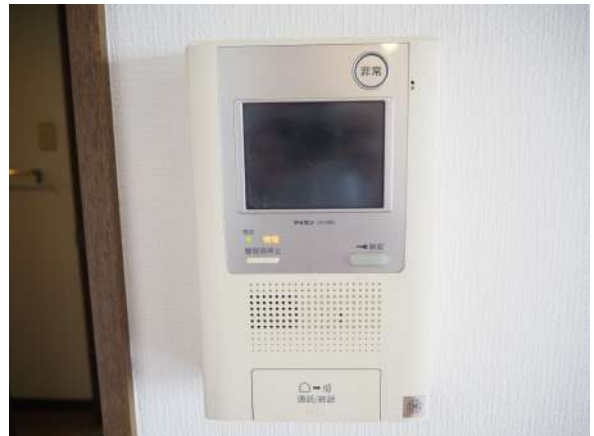
【防犯設備】テレビモニター付きインターホンでしっかり防犯対策!
