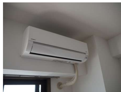
【冷暖房・空調設備】リビングには新品のエアコンを設置!
