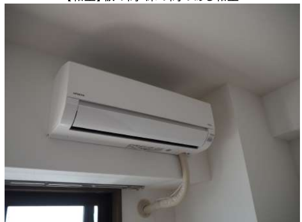
【冷暖房・空調設備】リビングには新品のエアコンを設置！
