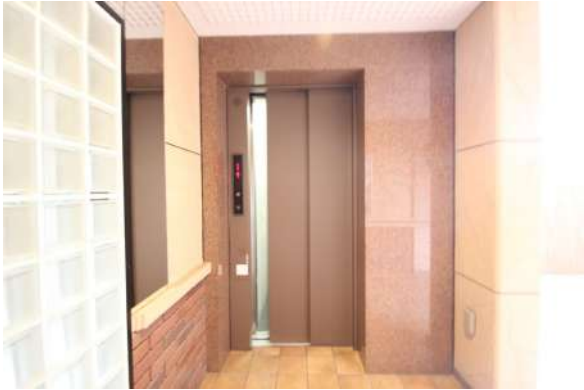
【その他共用部】棟内エレベーターです
