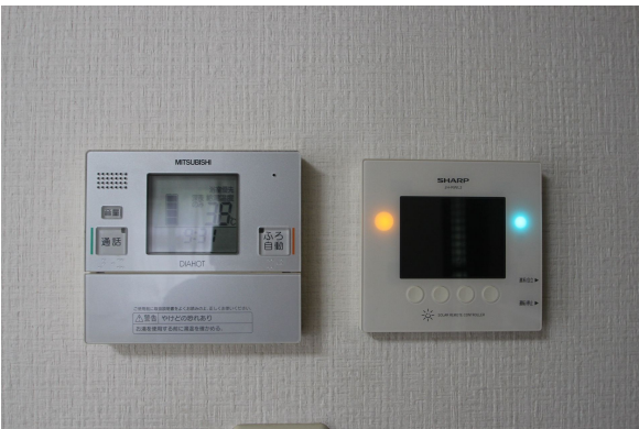
【その他設備】左が給湯器、右が太陽光発電モニター（ソーラーは6.52KWの）
